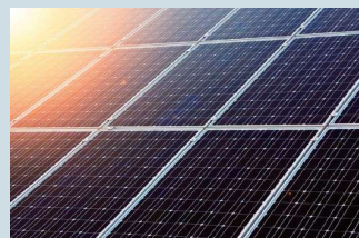
CASE.04 メガソーラー発電所
