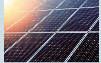
CASE.04 メガソーラー発電所
